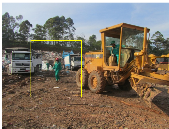
Figura 12 – Sinalizador Fonte: Informação interna
